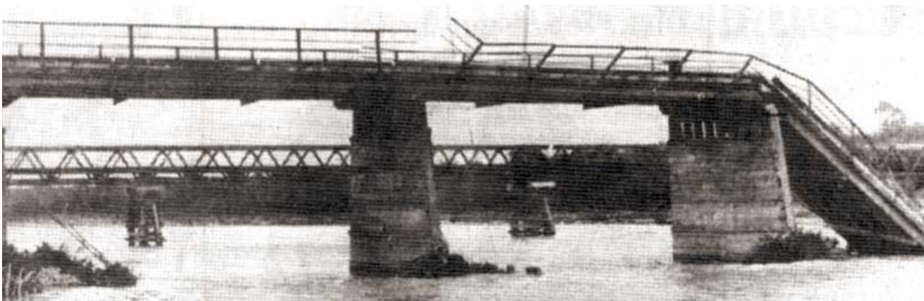
Die eingestürzte Hollenburgbrücke und dahinter die Behelfsbrücke
